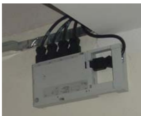
Die Schaltaktoren gesis ® RC V wurden mit vorkonfektionierten gesis ® CON-Leitungen schnell installiert.
